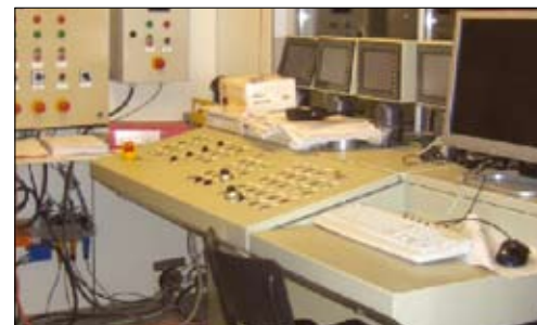
↑ Figuur 7 De besturings- en controle-unit ten behoeve van het boorproces
