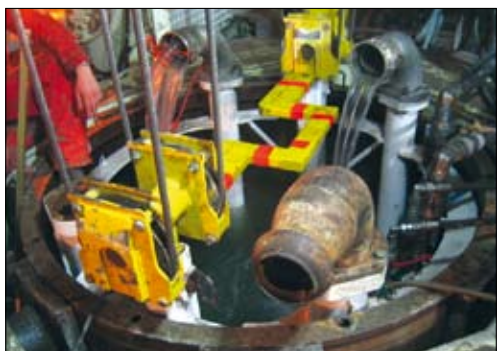
↑ Figuur 11 De korte MT paal is gevuld met water om voor het lossen van de balgen zoveel mogelijk een evenwichtssituatie te krijgen tussen de druk in en buiten de paal
