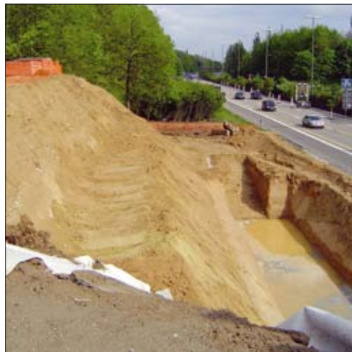
↑ Figuur 1 Talud waarvan de stabiliteit niet kan verklaard worden met de traditionele rekenmethoden
