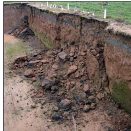
↑ Figuur 3 Afschuiving als gevolg van de infiltratie van water in het talud na slagregen
