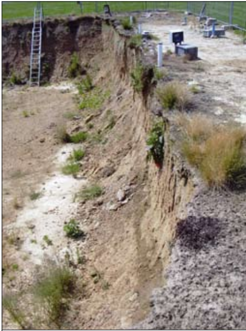
↑ Figuur 14 Oppervlakkige afschuiving van de niet-afgeschermd wand (april 2006)
