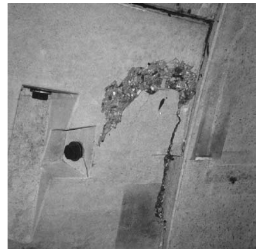
↑ Figuur 3 Karakteristiek schadebeeld bij betonbreuk door een overbelaste nok-deuk constructie
