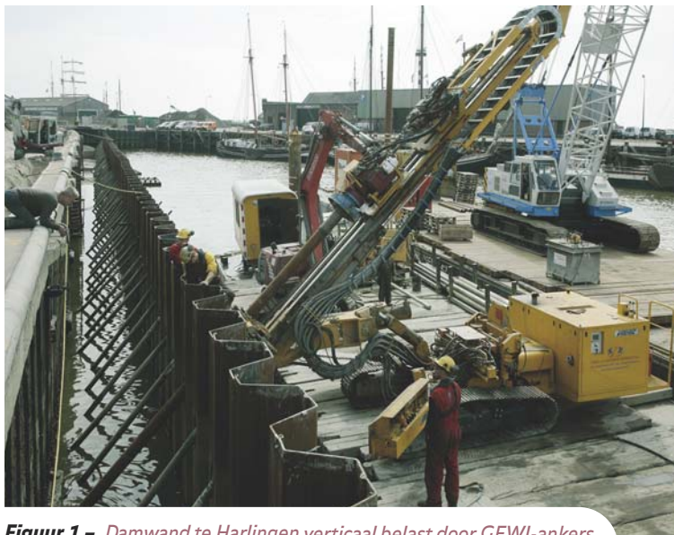
Figuur 1 – Damwand te Harlingen verticaal belast door GEWI-ankers.
