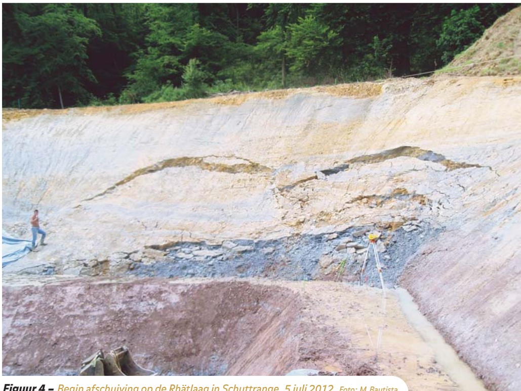
Figuur 4 – Begin afschuiving op de Rhätlaag in Schuttrange, 5 juli 2012. Foto: M. Bautista
