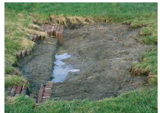
Figuur 4 Schade aan de onderkant van de dijk.
